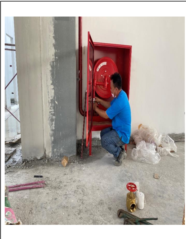
➤ ภาพถ่ายแสดงงานติดตั้งตู้ Fire Hose Cabinet เดินท่อ และทดสอบระบบ
